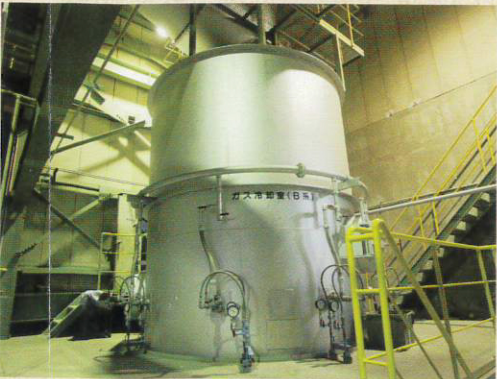
③ ガス冷却室
